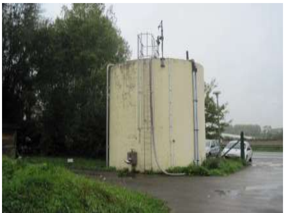
Vue du silo à boues
